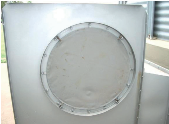
Figura 18. Tapa colocada en el aireador para evitar el "efecto chimenea".
