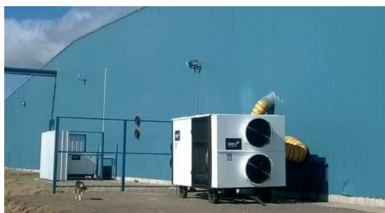
Figura 10. Equipo de refrigeración conectado a una cámara de semillas.
