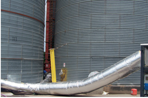
Figura 7. Conexión del equipo de frío a las 2 bocas de aireación de un silo.
