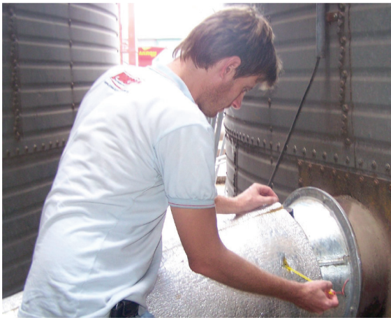
Medición de la temperatura de entrada del aire al silo.
