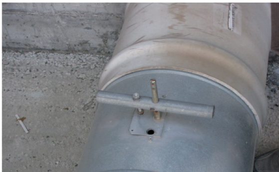
Figura 9. Compuerta para el cierre rápido del paso de aire al silo.
