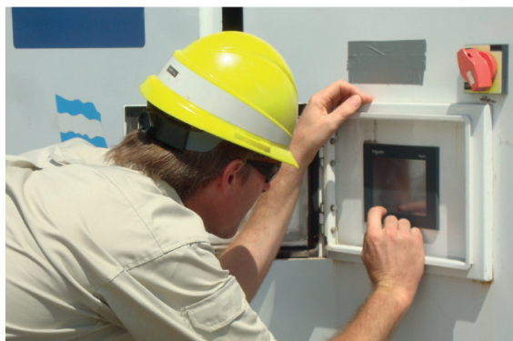
Figura 11. Panel de monitoreo y programación de la temperatura y humedad relativa del equipo refrigerador.
