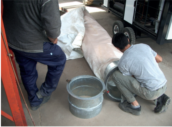
Figura 26. Conducto de lona térmicamente aislado y de color blanco.
