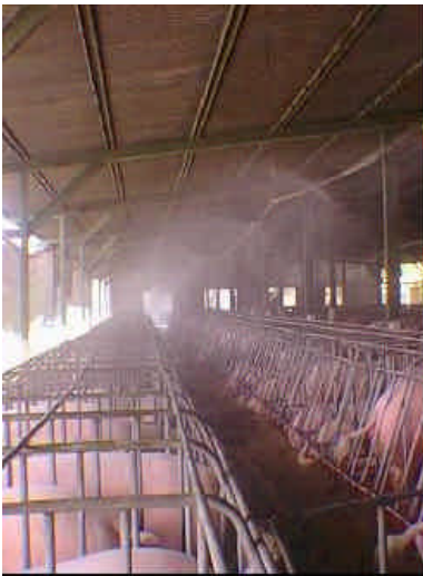
Sistema de aspersión automática en finca porcina
